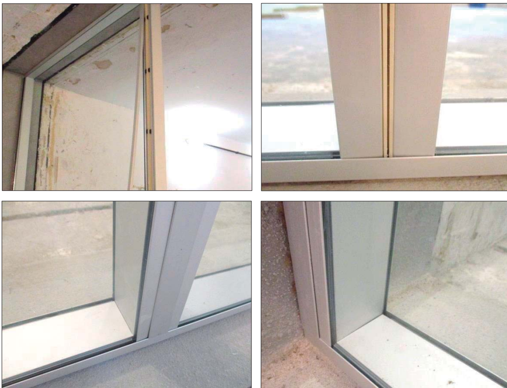
Imágenes 13 a 16 Instalación de los vidrios y su fijación a la estructura de soporte
